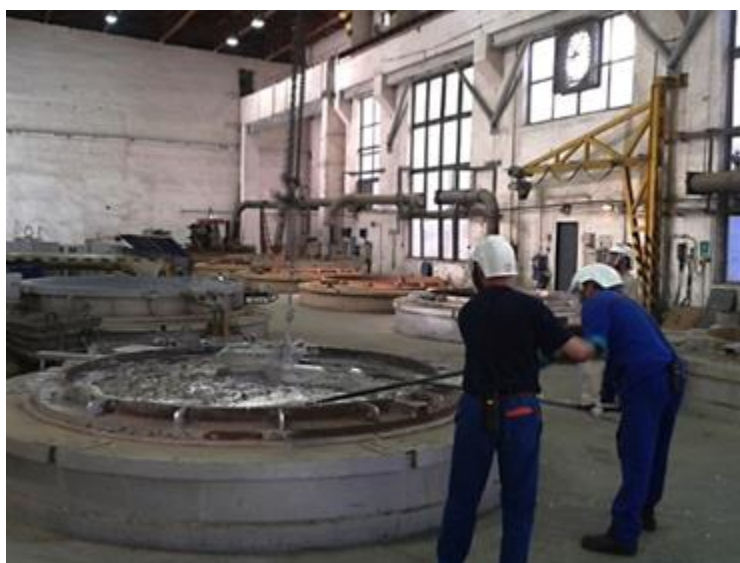
Obr. č. 9 Hala rafinace - část rafinačních kotlů
